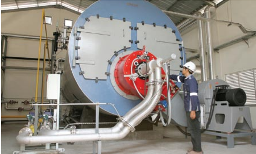
■ Boiler kapasitas dua kali 10 ton per-jam PT Enero
